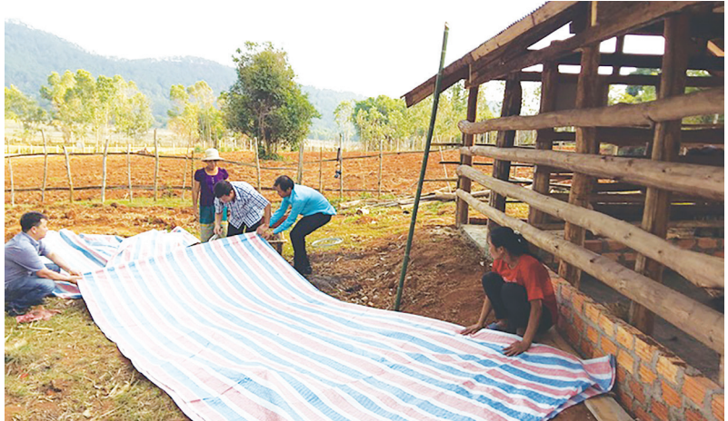
Tu sửa và chằng chống chuồng trại, mái chuồng để hạn chế tốc mái khi có bão
