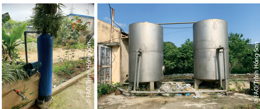
Hình 13. Hệ thống lọc nước của cơ sở chăn nuôi lợn
