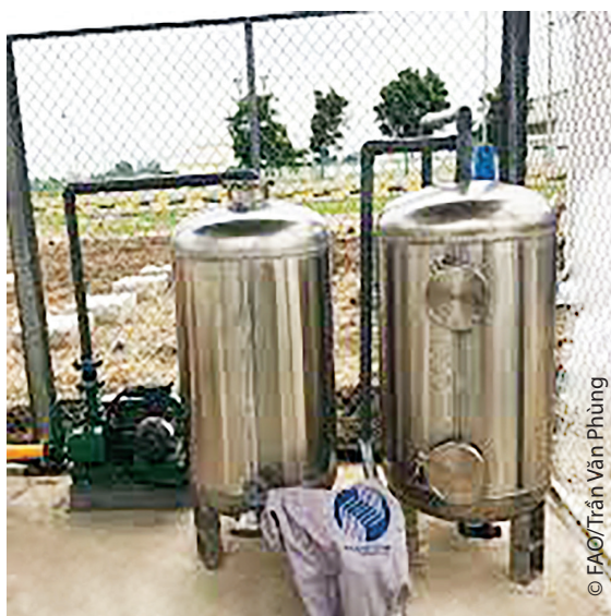
Hình 46. Hệ thống thiết bị lọc khí H_2S
