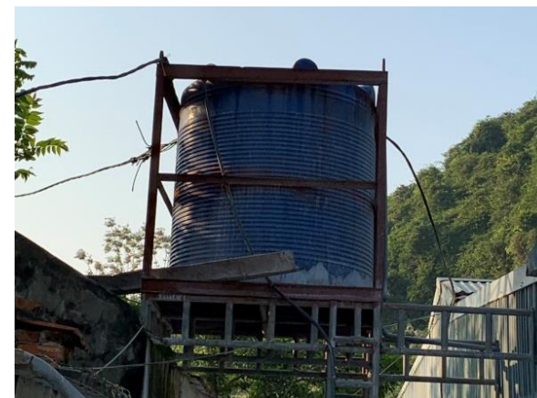
Hệ thống lọc nước
