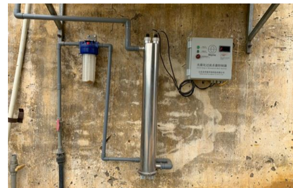
Hệ thống diệt khuẩn làm sạch nước ở đầu chuồng
