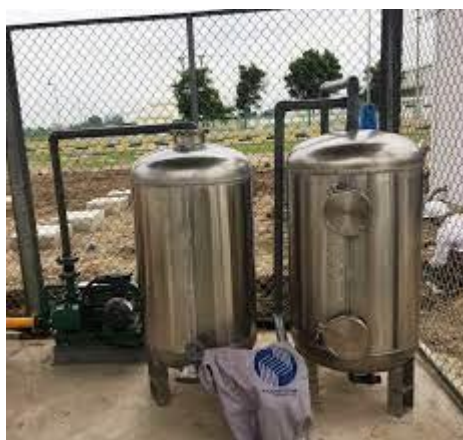
Hình 102. Hệ thống thiết bị lọc khí H_2S
