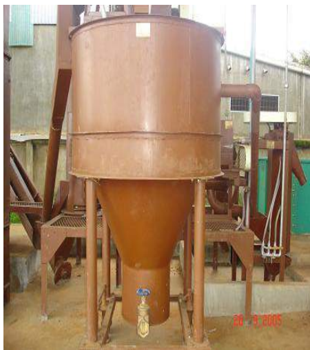
Hình 84: Bể siphon kim loại
